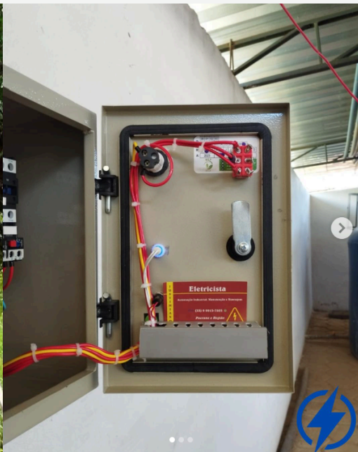
Investimentos elétricos no distrito Barra da Figueira, para promover estabilidade e segurança
